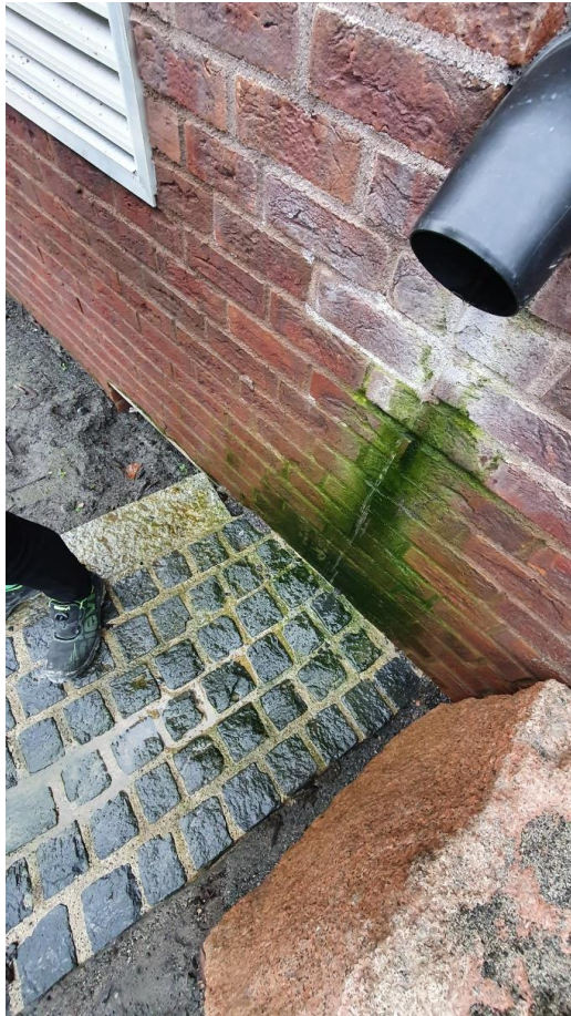
Bilde 10: Algedannelser på murfasade.
