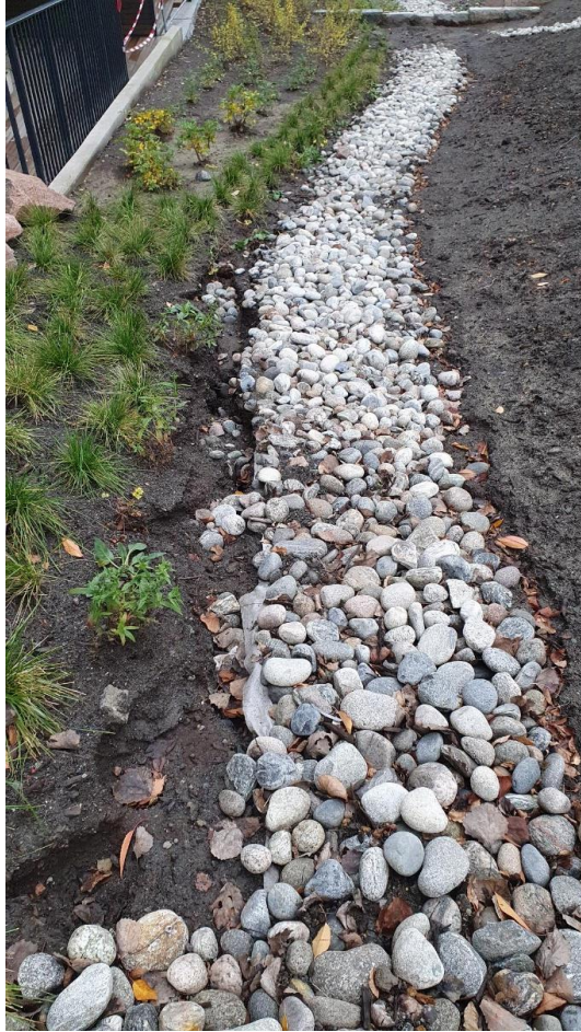
Bilde 4 og 5: Erosjon på grunn av filtduken under topplaget med elvestein.
