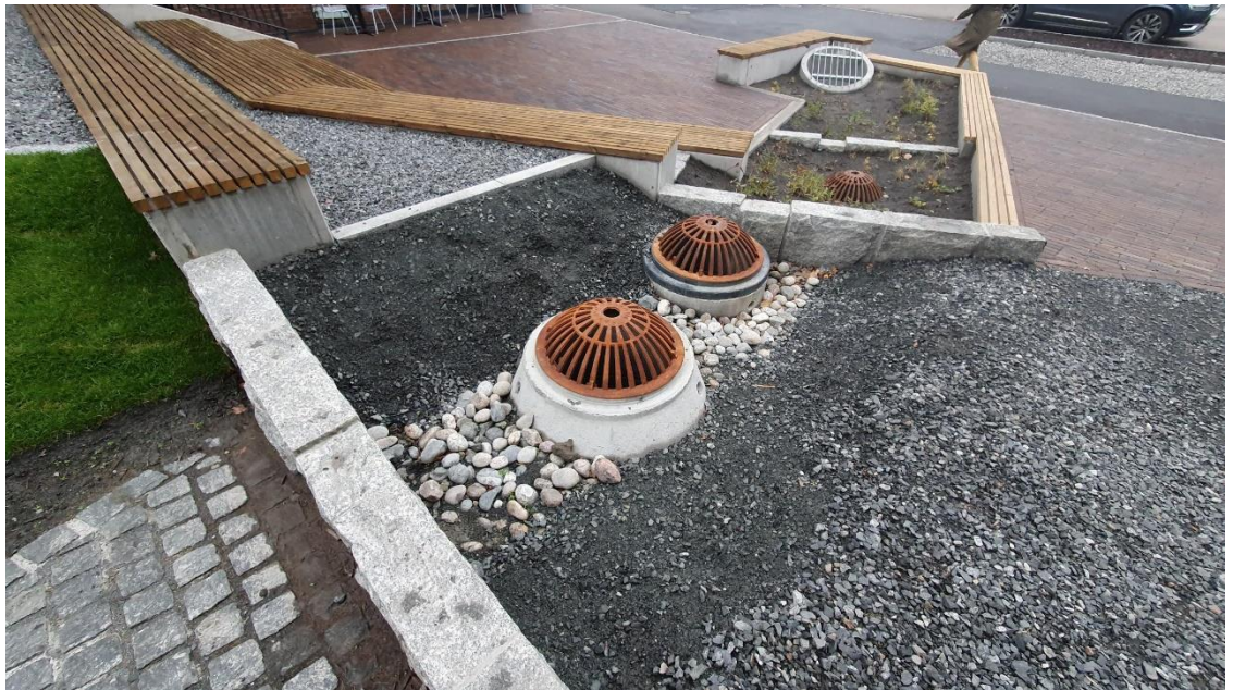
Bilde 1: Store kummer/sandfang og er enormt utløp, og manglende vekstjord og beplantning i det ene trauet.
