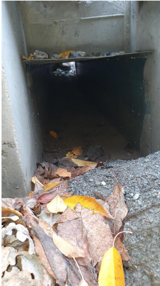
Bilde 13: Vannet har problemer med å renne ut av betong kloppen og ut i overvannsløsningen grunnet mye og høye omkringliggende masser.
