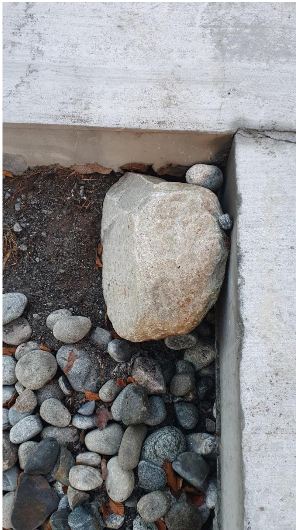
Bilde 18 og 19: Første bilde viser undergraving av en betong klopp og andre bilde viser en stein som entreprenør har plassert for å skjule hullet.
