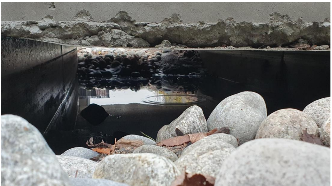
Bilde 14: Stillestående vann inni betong kloppen.
