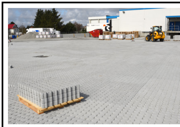
På Tine Grannes i Sola ble det i mars - april 2018 lagt et permeabelt industridekke på 4200 kvadratmeter, på et areal hvor grunnen er lite egnet for infiltrasjon.
